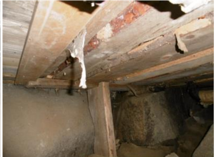
Även delar av torpargrunden visar några spår av tidvis fuktigt klimat.
