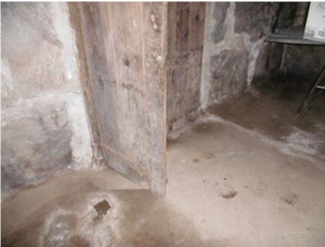
Källaren visar spår av tidvis fuktigt klimat.
