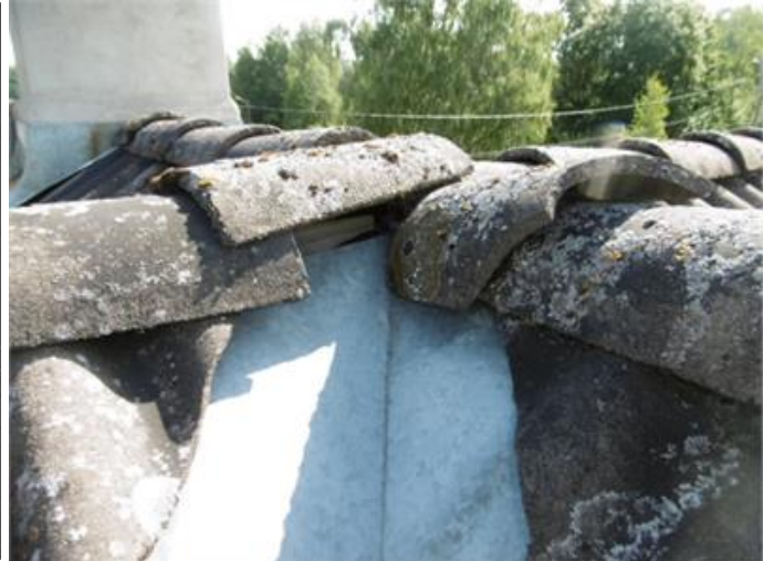
Ett antal enstaka bristfälliga takövertäckningar förekommer vid tak.
