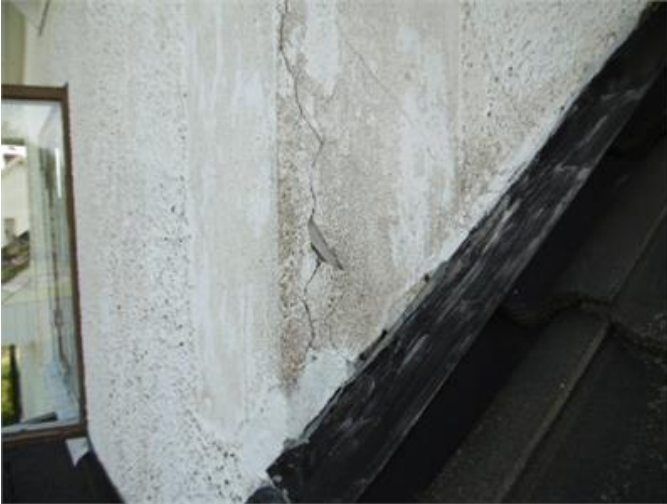
Delar av fasader visar underhåll/restaureringsbehov.
