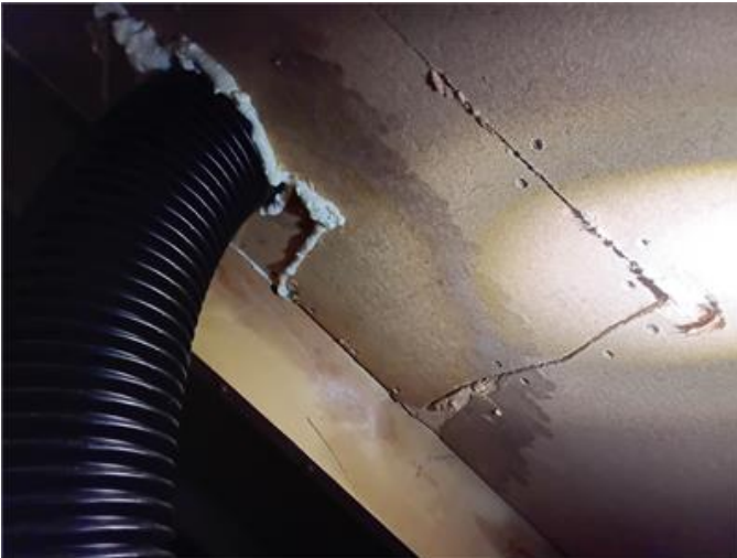
Fuktfläck intill avluftning.
