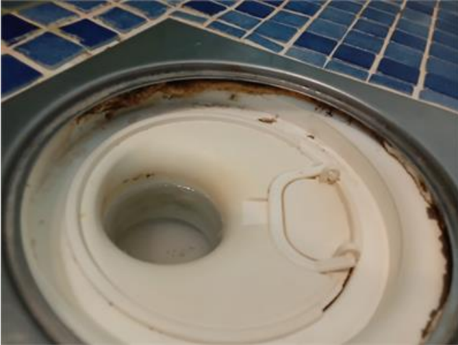
Golvbrunn med avsaknad av klämring i badrum på entréplan
