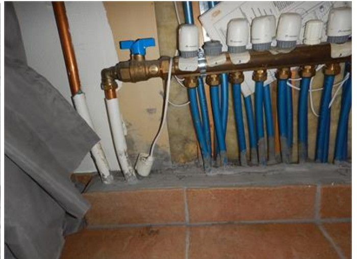
VVS: Golvvärmefördelare är placerad i öppen vägg. Det finns batteridrivna läckagevarnare som med fördel kan användas i denna typ av utrymme/installation
