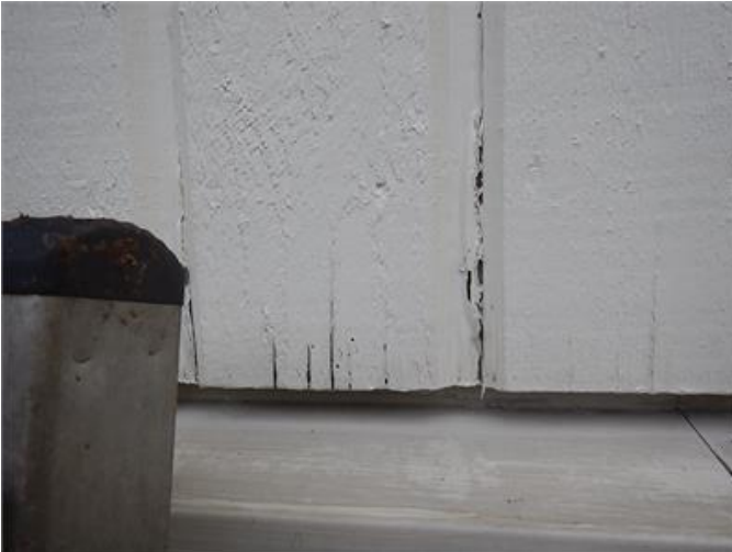
Fasad: Fasadpanel har lokalt rötskador ovan midjeplåten i brädornas ände på sida åt söder.
