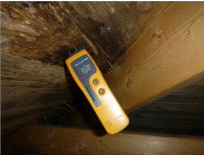
Bilden visar fuktfläck i underlagstaket.
