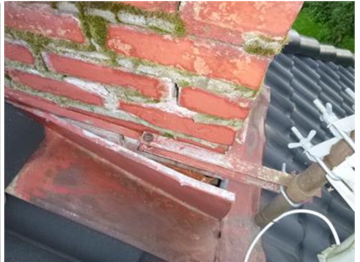
Bilden visar otätheter i skorstenen/skorstensplåten.
