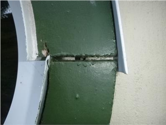
Bilden visar exempel på otätheter/brister vid fönster/fönsterplåt.
