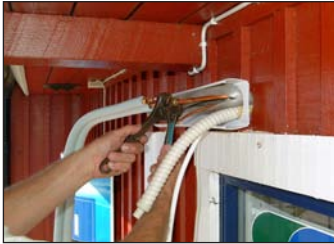
25. Koppla rören som skall gå till utedelen. OBS! Ni måste dra muttrarna ordentligt. Använd mycket kraft! Annars risk för läckage!
