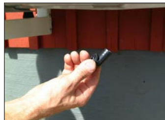
30. Bifogad rökoppling, som ska sitta under utedelen, ska inte monteras. Den orsakar isbildning och kan ställa till problem. Bättre utan!
