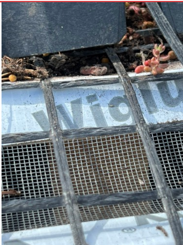
TAKSAMMANSÄTTNING EJ FACKMANNAMÄSSIG Närbilds. Blottat obehandlad takläkt syns på bild under Insektsnät
