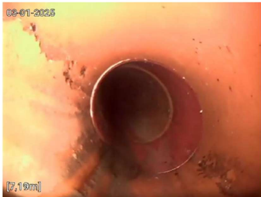
Ledning deformerad vid ca 7,40 meter, grad 2.
