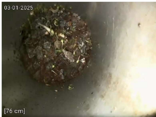
Grenledning för kök innan slamsugning. Ledning full med sten/grus. Grad 4.
