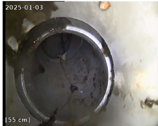
Axiell fogförskjutning efter ca 0,7 meter, grad 3.
