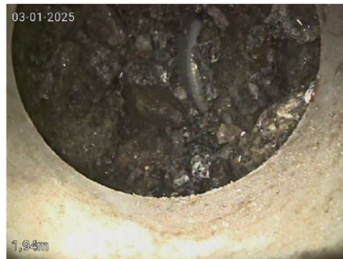
Grenledning för kök efter slamsugning, grad 4. Ledning har gått isär och man kan skymta fortsättningen på ledningen bland gruset.
