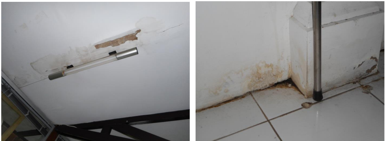
Figur 26 Synliga invändiga fuktskador i byggnaden (Gustafsson, 2015).
