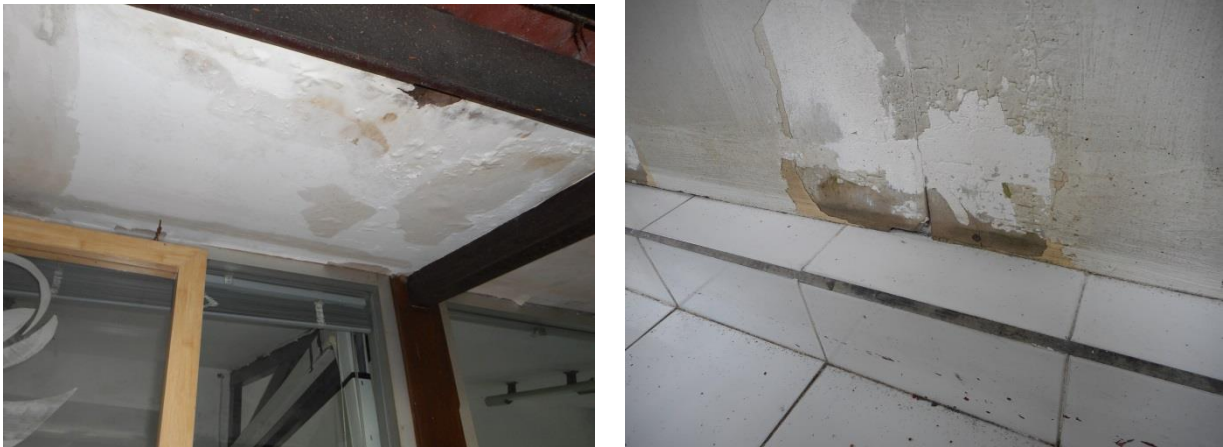
Figur 24 Fuktskador på takfot samt puts som släppts från fasad (Granberg, 2015).
