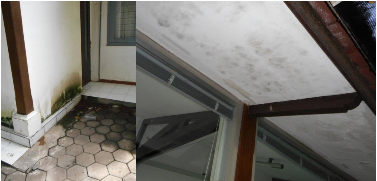
Figur 3 Fuktskador i form av mikrobiell påväxt samt mögel (Gustafsson, 2015).
