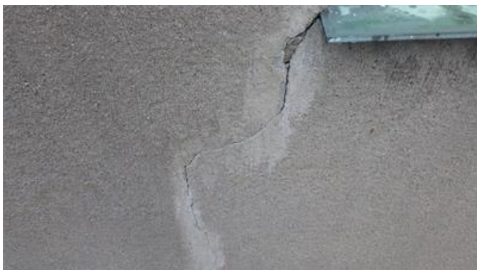
Spricka i grundmuren
