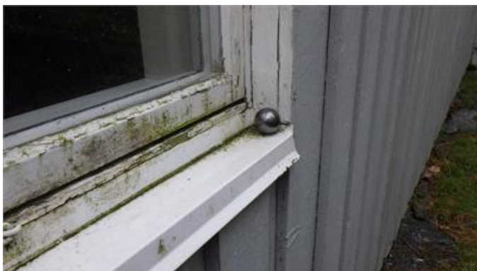
Bakfall på fönsterbleck
