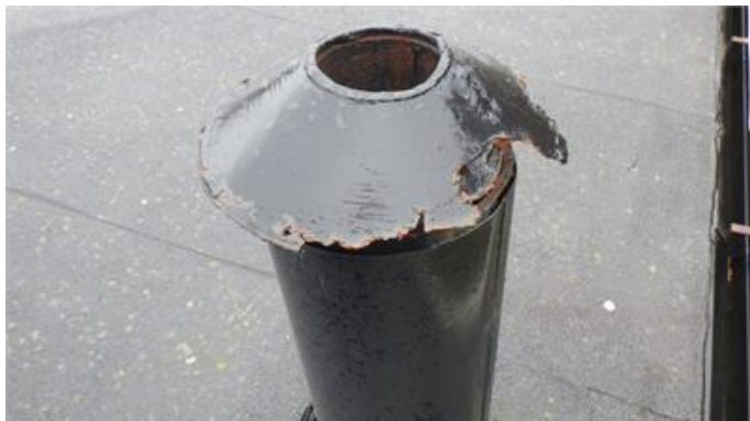
Sönderrostad huv på yttertaket
