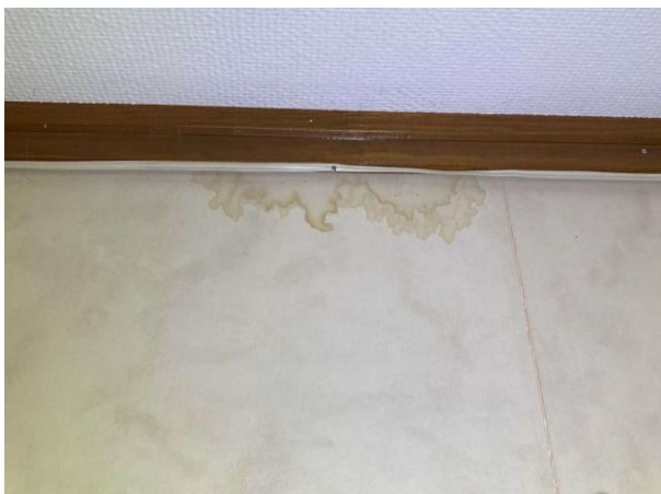
Bild 3: Invändigt, Entréplan, Vardagsrum, Fuktläckar på vägg mot taket (torrt vid besiktningstillfället)
