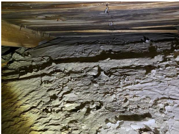
Bild 1: Utvändigt, Vind, Huset är självdragsventilerat, se riskanalysen På vinden noterade spår av läckage på underlagstaket samt på isoleringen (torrt vid besiktnin...
