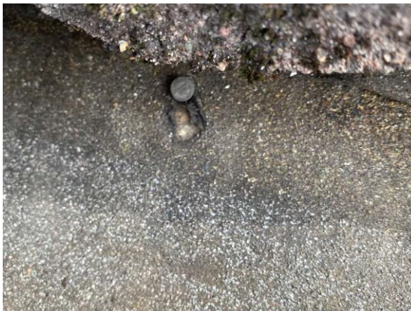
Bild 2: Utvändigt, Tak, Äldre tak Skador noterades i takpappen Utfört utan nocktätning Snörasskydd saknas Torrsprickor samt rötskador noterades på vindskivor Budget...
