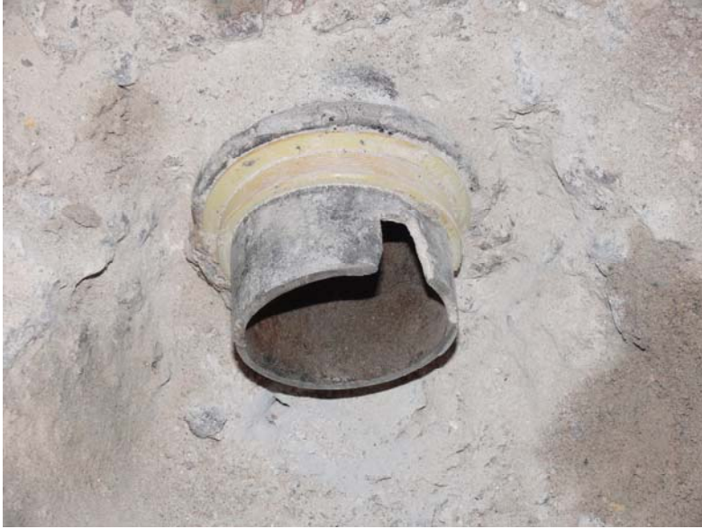
Figure 1 Gamla gjutjärnsröret fast i gjutjärnsbøj.
