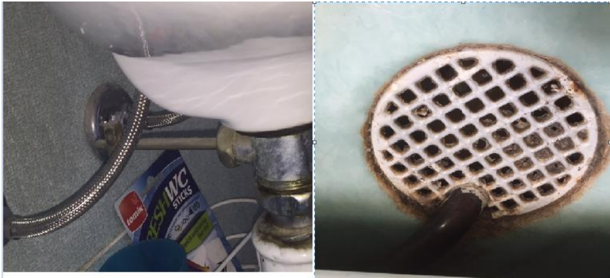
3. Bild ett, rör genomföring badrum, kanske inte mycket att säga om. Bild två, golvbrunn i badrum, vet ej om det är plast eller gjutjärn.
