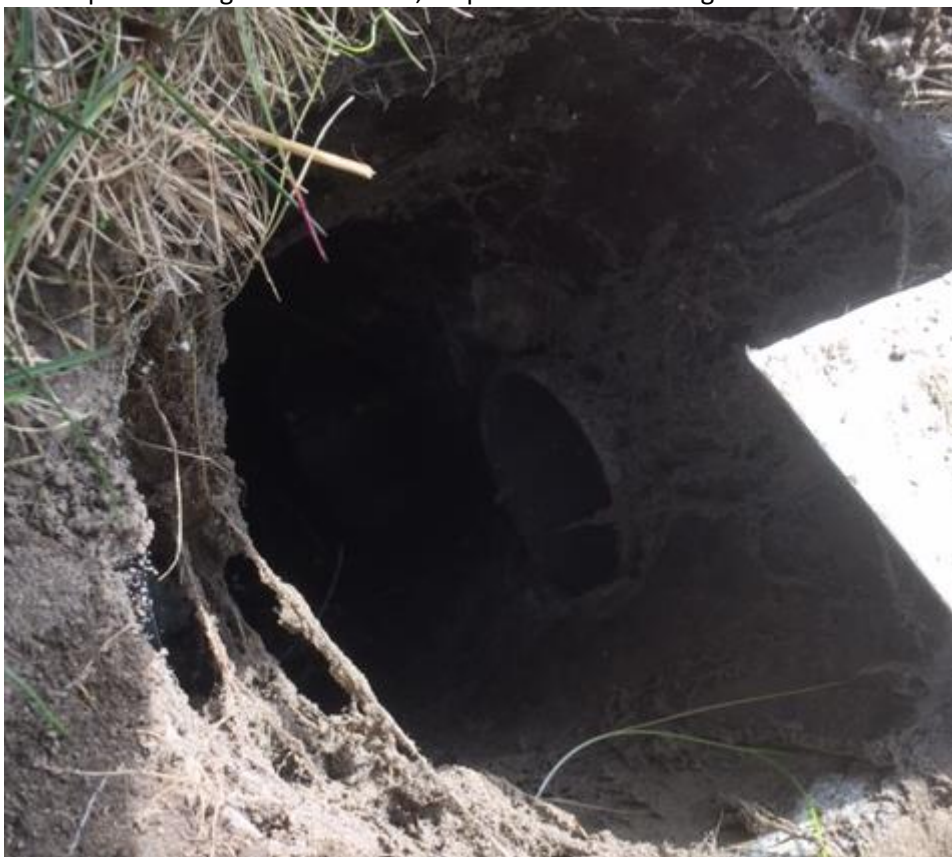
23. Under plåten där stuprännan kommer ut på ena sidan huset. 60-70cm ner i röret stod det vatten .
