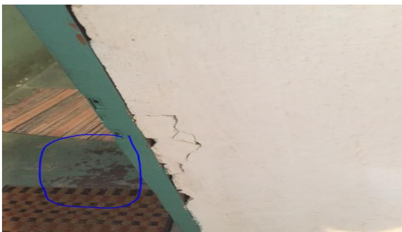
13. Lite färgsläpp på golv och väggar i källare, problem eller marginellt? Noterade också en typisk källardoft - unken/avlopps- doft, källaren är dock helt rå och oinredd och är inte planerad att inredas eller bo i de närmsta åren.
